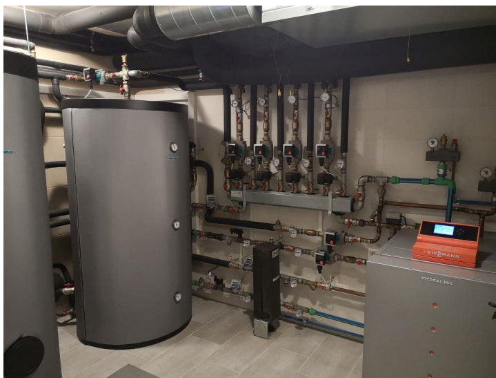
Slika 48. Dizalica topline voda-voda
